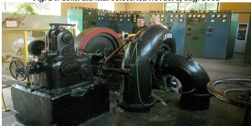
Fig. 24. Centrala hidroelectrică Novaci 1, aug. 2003
